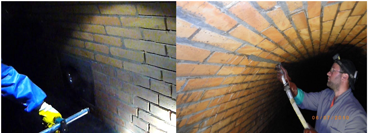
Abbildung 10: Renovierung (Mauerwerkverfugung) hier: Ausräumen des alten Fugenmörtels und Verfugen der ausgeräumten Fugen
