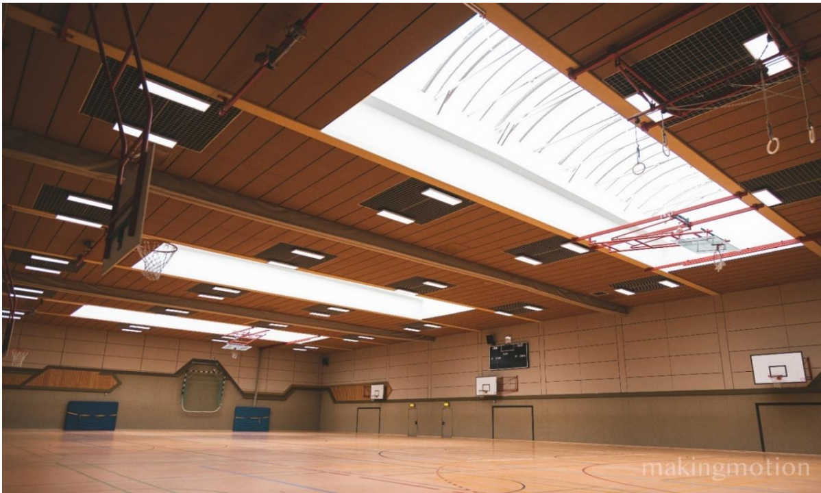
LED-Beleuchtung in der 3fach-Halle BSA Lichtenbroich (Franz-Rennefeld-Weg):
