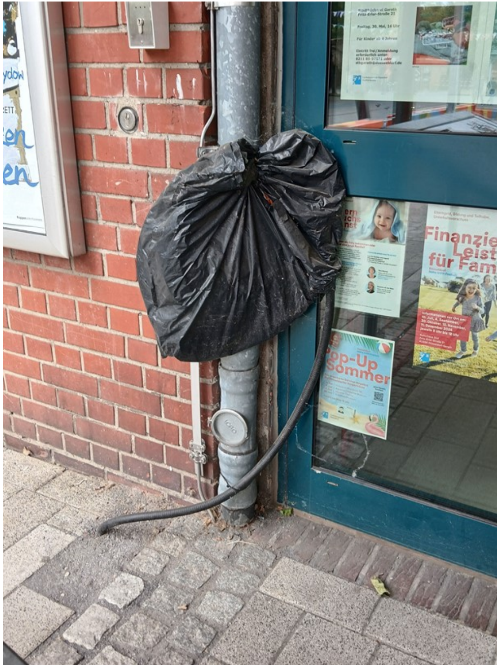
Ein Rohr, das mit einem Plastiksack eingewickelt ist.
