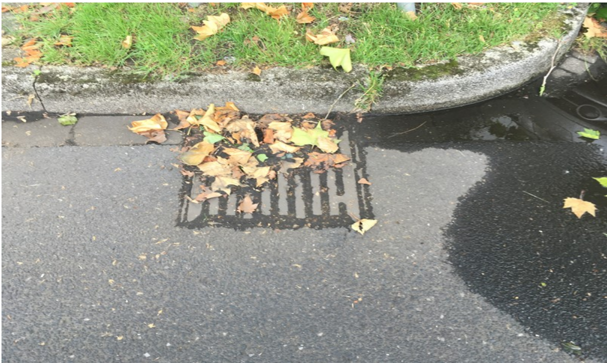
Bild 2: Verstopfter Abfluss auf der Fahrbahn Dresdener Straße
