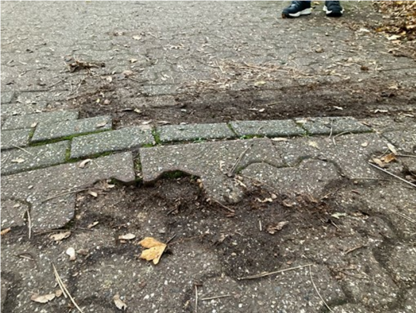
Anlage zum Antrag BV10/086/2025: Bilder Schäden auf Fuß-Radweg Helene-Weber-Straße
