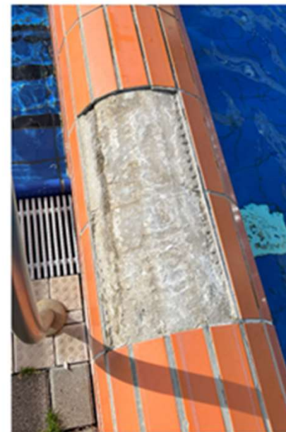
BELAGS- UND KONSTRUKTIONSSCHÄDEN
