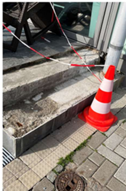
BELAGS- UND KONSTRUKTIONSSCHÄDEN FROSTSCHÄDE
